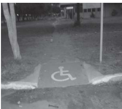
Foto 9: Rampa sem caminho acessível.
