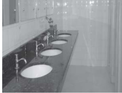
Foto 4: Banheiros sem acessibilidade
