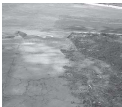
Foto 8: Caminho com pista danificada
