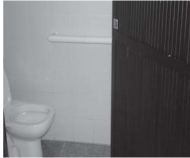
Foto 2: Sanitário fora da norma da ABNT. Porta abrindo para dentro.
